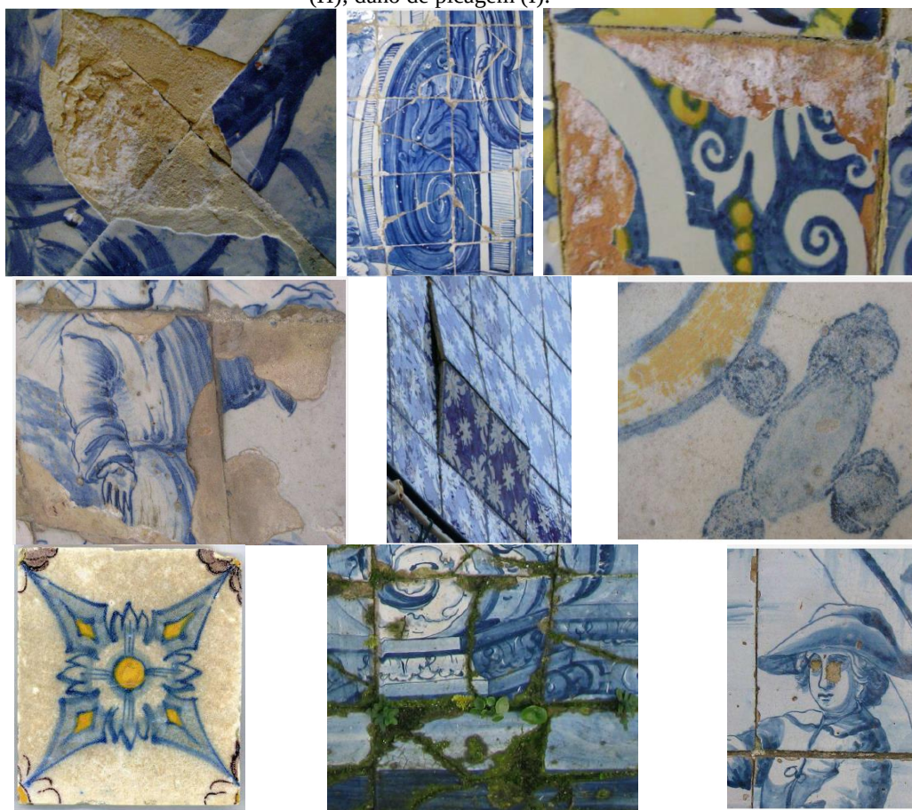
Figura 23 – Exemplos de deteriorações em azulejos: desagregação da chacota (A); fratura (B); eflorescência (C); falha e destacamento do vidrado (D); barriga (E); abrasão (F); vidrado pardo (G); colonização (H); dano de picagem (I).
