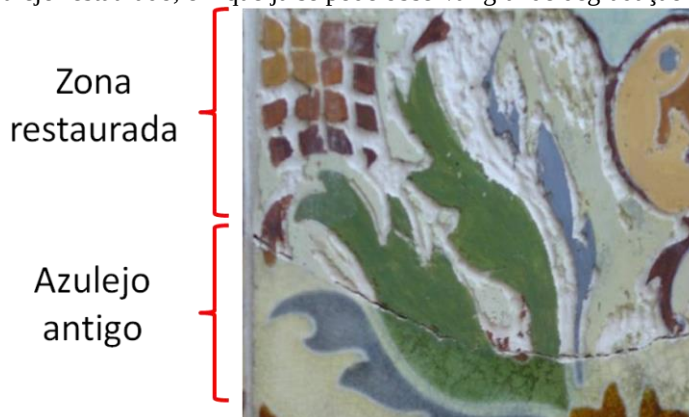
Figura 30 – Azulejo restaurado, em que já se pode observar grande degradação da área nova.
